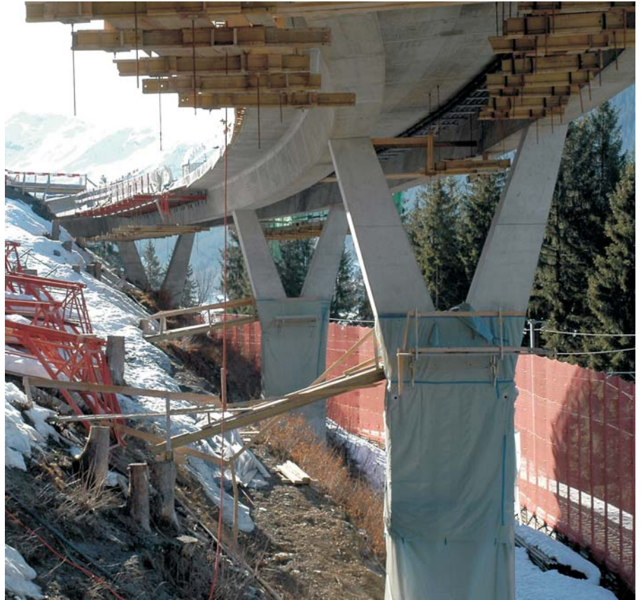
Bau der Hexentobelbrücke im beengten Raum zwischen der Prättigauerstrasse und den Geleisen der Rhätischen Bahn.
